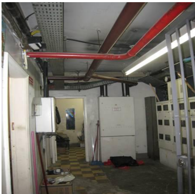
SITUAÇÃO ANTIGA : PAINEIS ANTIGOS SEM PROTEÇÃO FORA DA NORMA
