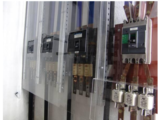
SITUAÇÃO ATUAL : DISJUNTOR COM BARRAMENTO AMPLIADO COM PROTEÇÃO POLICARBONATO
