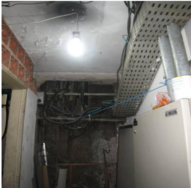
SITUAÇÃO ANTIGA : SEM PRUMADA E PROT. MECANICA , CABOS SOLTOS
