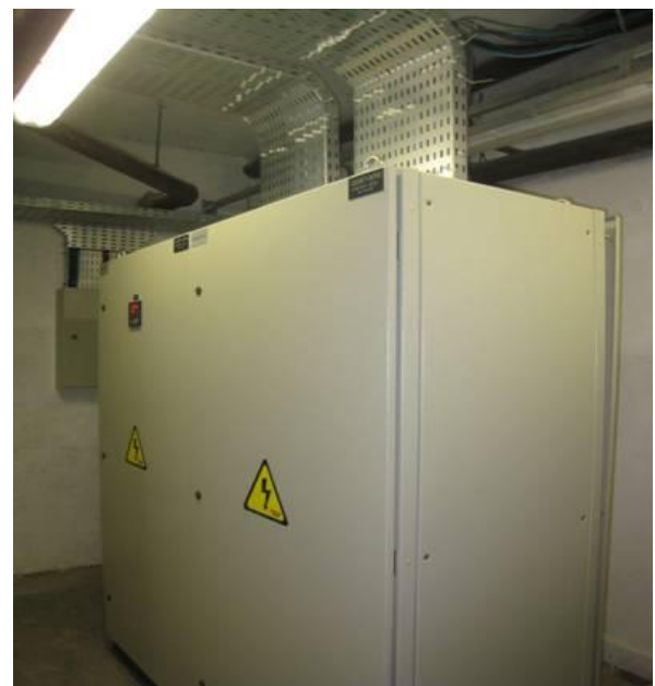
SITUAÇÃO ATUAL : PAINEIS COM MULTIMEDIDOR DENTRO DA NORMA, DISJUNTORES CAIXA MOLDADA INTELIGENTE COM BARRAMENTO COM PROTEÇÃO POLICARBINATO E TRANSPARENTE E PROTEÇÃO DE SURTO
