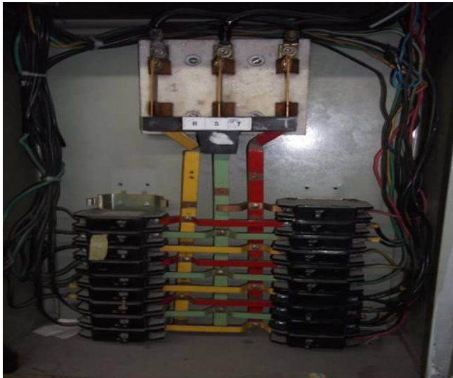
SITUAÇÃO ANTIGA : QUADROS ANTIGOS SEM PROTEÇÃO ADEQUADA
